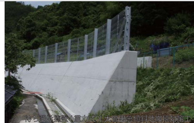
待ち受け擁壁 (重力式) [ 大曾里急傾斜地崩壊対策工 ]
